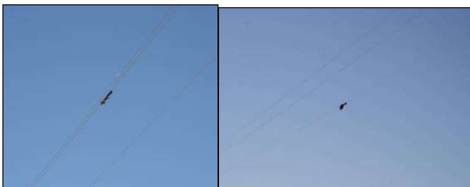
Fotografias 14 e 15 – Exemplos de deslizamento de material anti-electrocussão nas linhas corrigidas no âmbito do Protocolo Avifauna I.
