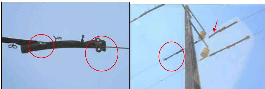
Fotografias 6 e 7 – manga extensora com deficiências na fixação e conseqüente rotação e apoio tipo GAL com isoladores que sofreram rotação e deslizamento.
