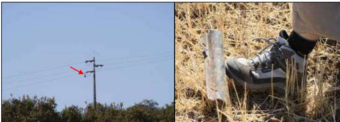
Fotografias 12 e 13 – Apoio com dispositivo anti-electrocussão caído no chão.
