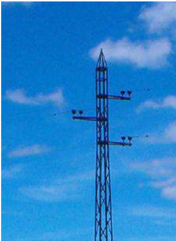
Apoio de metal em Galhardete com isoladores rígidos duplos e cabo de guarda
