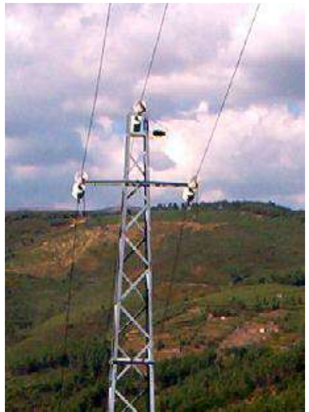
Apoio em amarração de 15Kv
