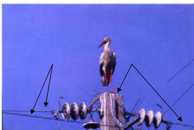
Imagem 2- Cegonha Branca ( Ciconia Ciconia ) num apoio tipo GAN, com elevado risco Electrocutação entre fases (a) e entre fase e neutro no apoio (b).
