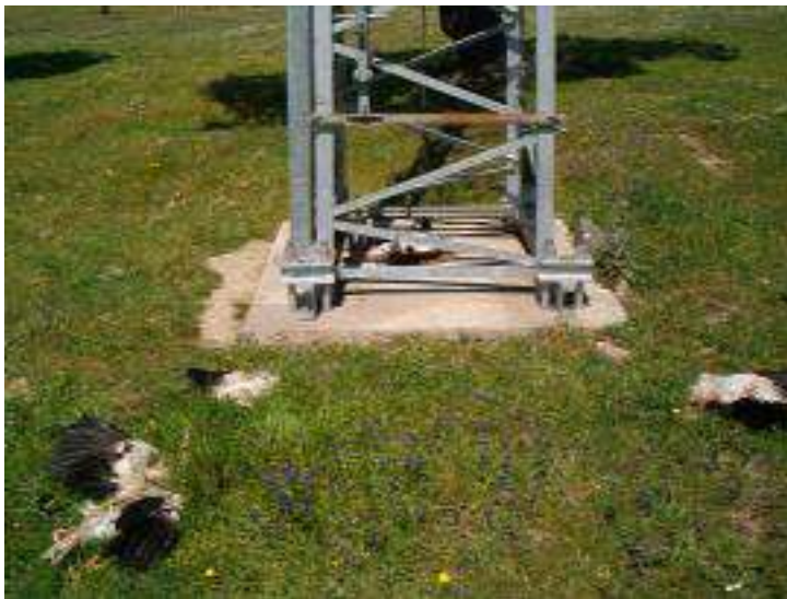
Foto 8 e 9 - Em cima três Juvenis de Cegonha Branca electrocutadas num apoio, ao lado um Corvo electrocutado
