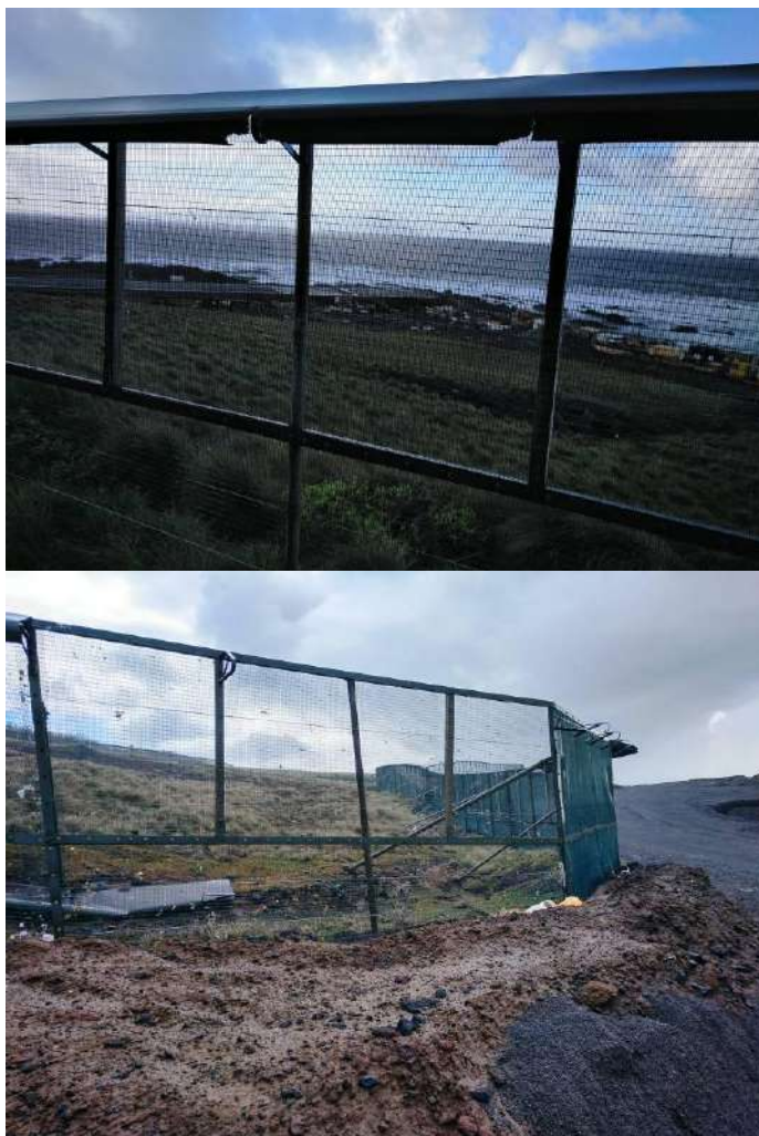
Figura_5 Deterioração das chapas devido à oxidação (superior), destruição das chapas com a tempestade (inferior)
