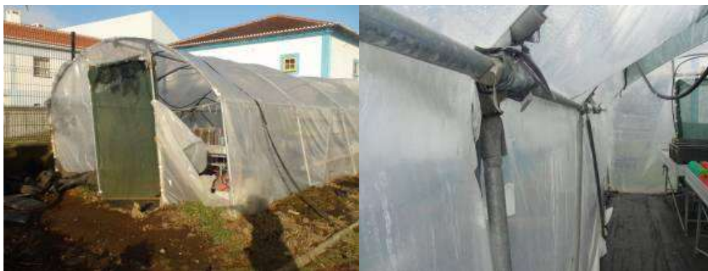
Figura 26_ Estrutura do estufim danificada após tempestade de fevereiro de 2014
